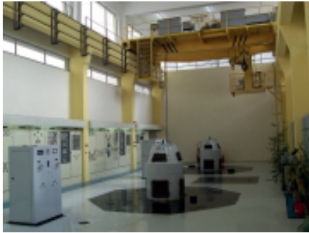
Hidrocentrala Paltinu – Sala mașinilor
